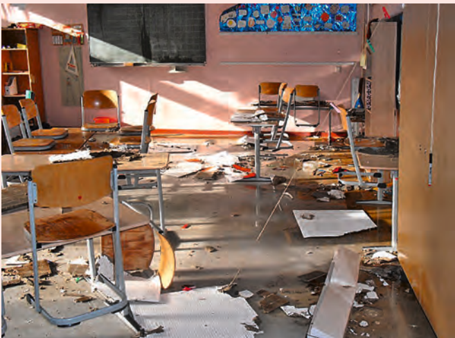
↑ Zustand des Raumes nach einem Wasserschaden
